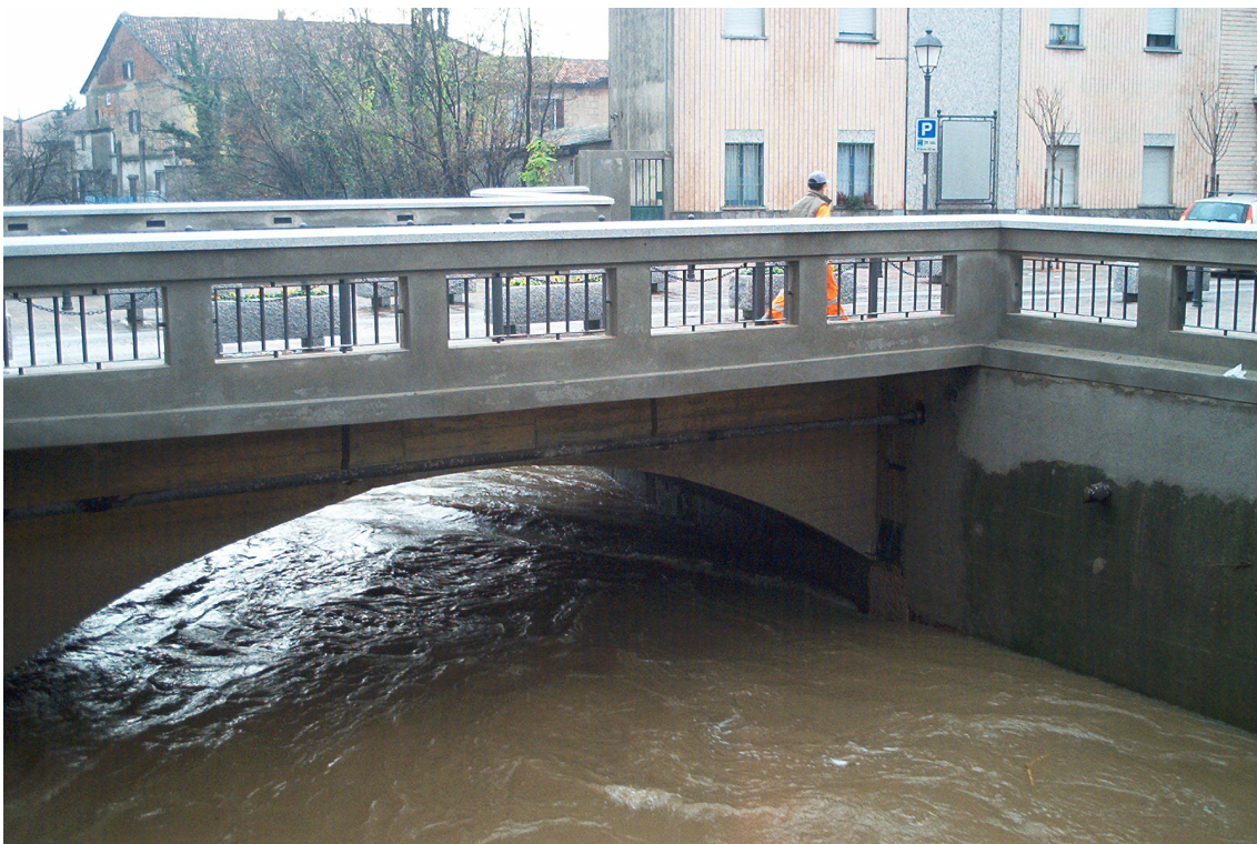
Fig. 10 - Ponte sul Seveso di Via Isonzo (Evento meteorico del 25 novembre 2002)
