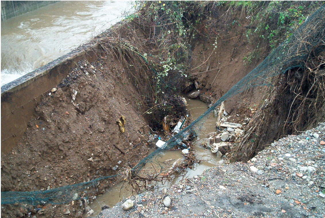
Fig. 11 - dissesto: sponda di sinistra del Seveso presso Via Comasinella (Evento meteorico del 25 novembre 2002)
