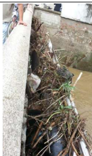
Foto 6 – Lato di monte del Ponte di via Marconi le evidenze del passaggio della piena
