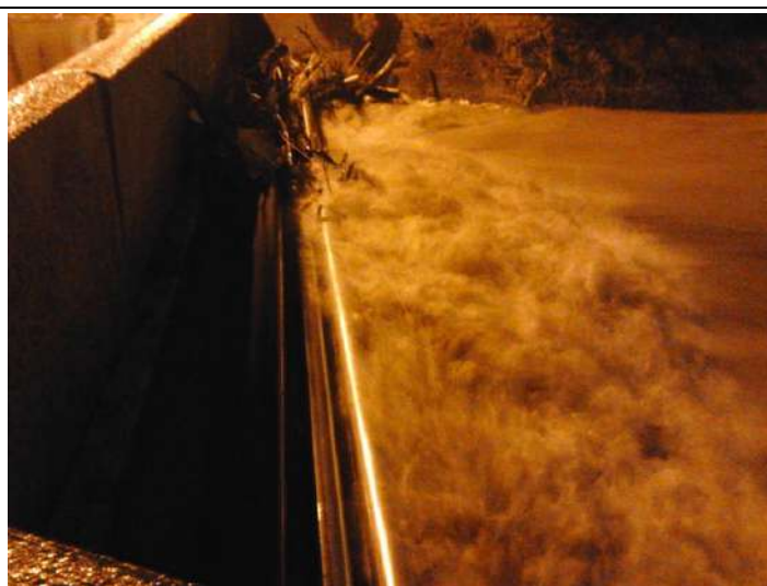
Foto 5 – Lato di monte del Ponte di via Marconi durante l'evento
