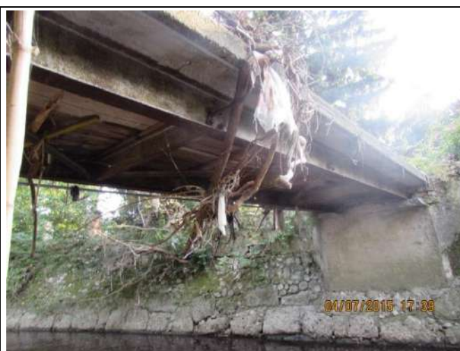
Foto 10 – Intradosso della passerella con evidenza dell'avvenuta interferenza con il deflusso di piena
