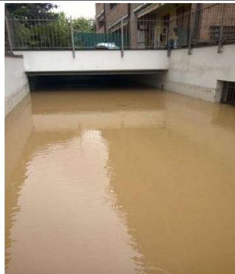
Foto 18 – L'allagamento delle autorimesse dell'edificio di via Lambro n. 18
