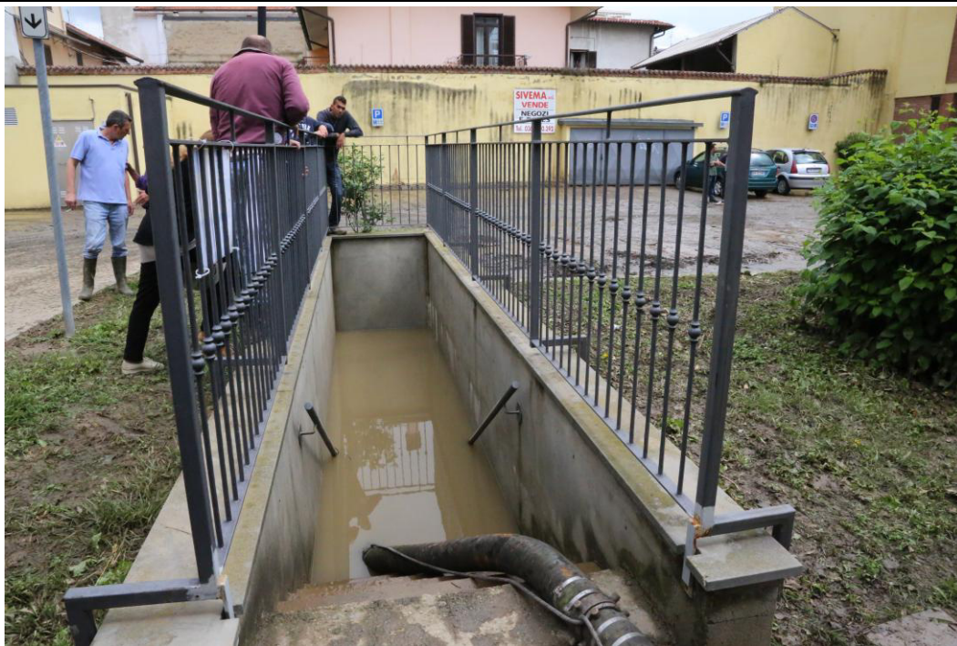
Foto 5 - Disagi in seguito all'evento alluvionale del luglio 2014 del Torrente Seveso nel Comune di Bovisio Masciago
